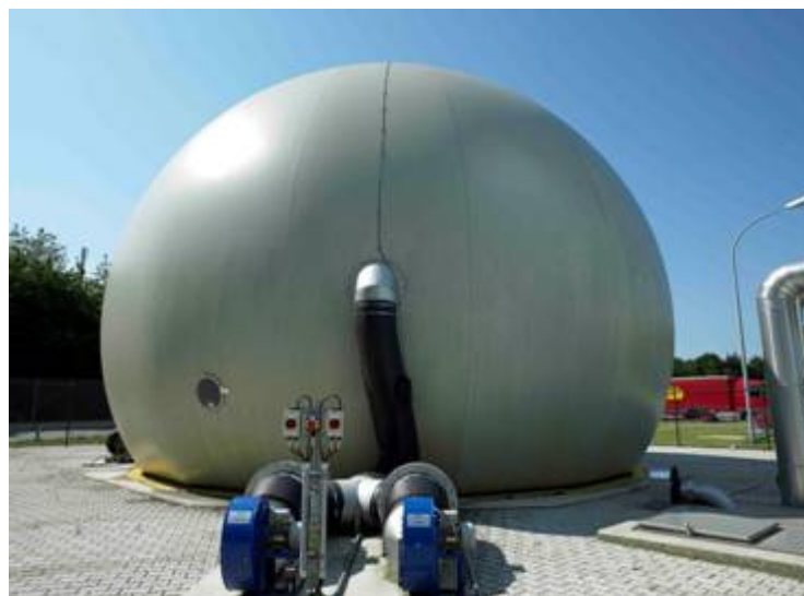
Слика 3-113: Резервоар за складирање на биогас од ферментаторот за отпад
